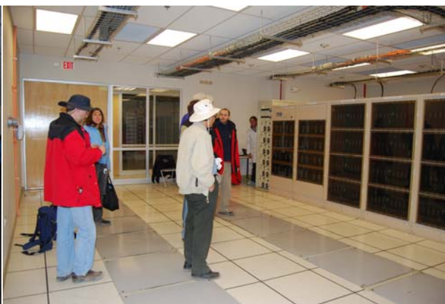
▲受信装置等各種の機器の整備も進んでいた(2008年12月)
